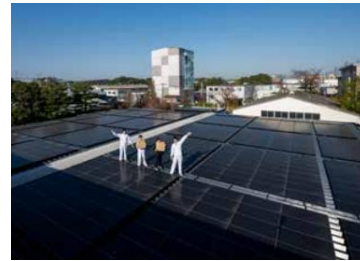
本社屋上の太陽光発電パネル
